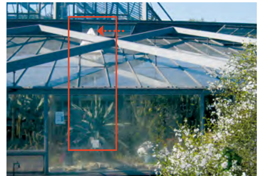
Die Agave wächst durch das Dach
